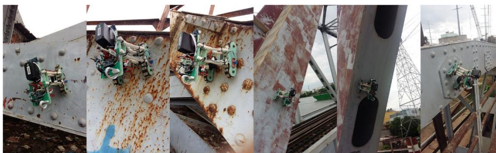
شکل ۸- ربات تشخیص خرابی پل‌های فولادی توسعه داده شده توسط نگین [۱۸]
