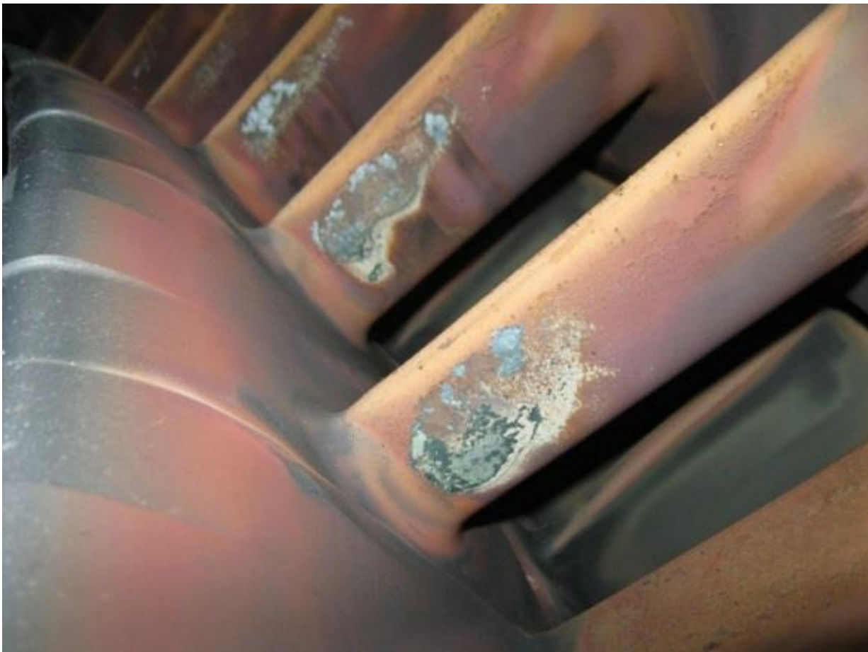
شکل 13: نمونه خوردگی موجود در واحد 2 نیروگاه خرمشهر
