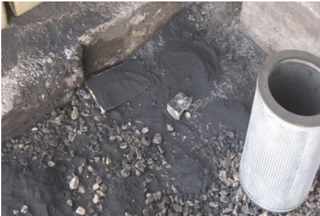
شکل 6: نمونه فیلتر تعویضی در ایستگاه گاز
