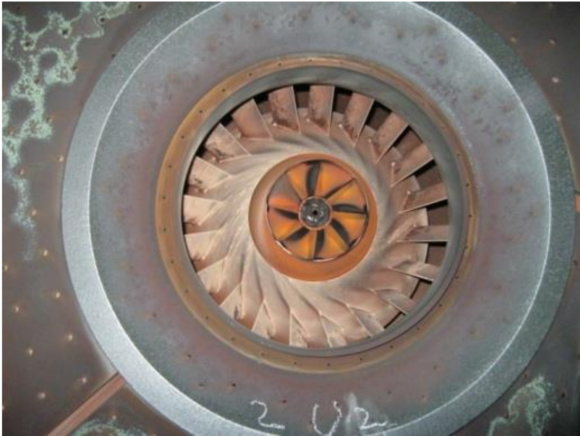
شکل 5: اثر خوردگی بر روی برنرهای واحد 2 نیروگاه خرمشهر
