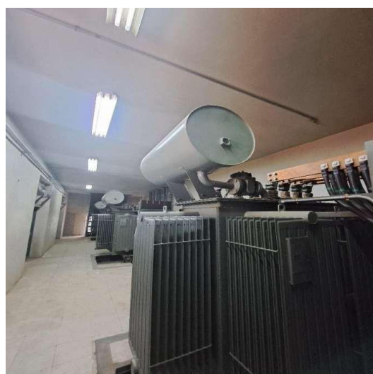
شکل ۲- نمایی از چیدمان داخلی ترانس های پست شرکت آردداران
