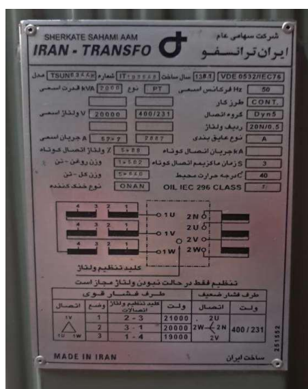
شکل ۳- پلاک یکی از سه ترانسفورماتور پست شرکت آرداران
