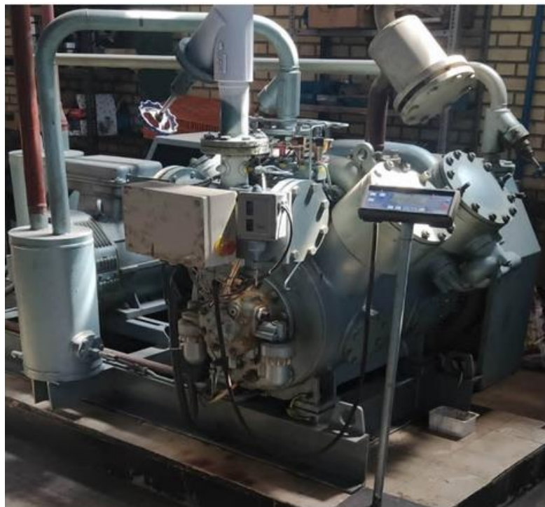
شکل ۵ - کمپرسور تک مرحله ای زیر صفر (پس از تغییرات) که وجود یخ زدگی بر روی لوله نشان دهنده عملکرد صحیح تجهیز میباشد.
